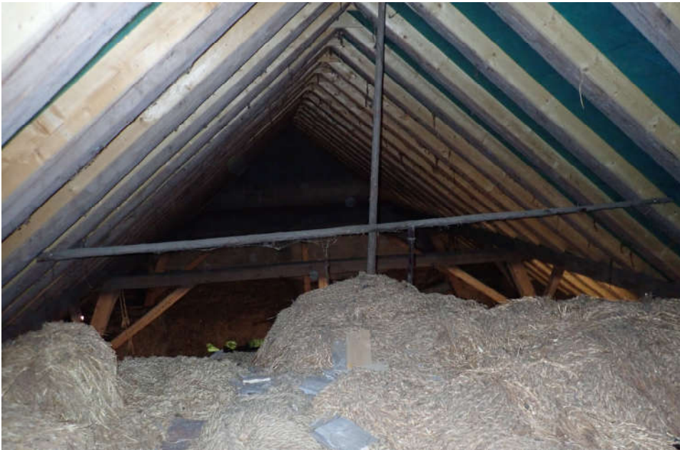
Dachbereich des Gnadenhofs
